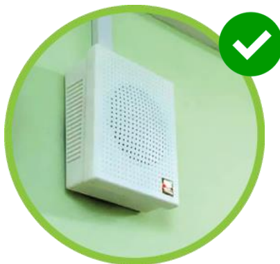
Аудиотрансляция в здании (при необходимости)
